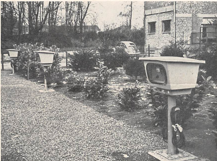
Vue des trois chargeurs fixes permettant à chacun d'alimenter deux autobus. Cette photo a été prise à Oreye (groupe de Liège) où il y a 8 postes en fonctionnement. Après l'hiver, une couche de tarmac recouvrira la pierraille.
