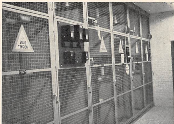
Une nouvelle cabine à haute tension a été installée et a fait l'objet de soins particuliers: le courant industriel est amené ici sous 15.000 volts et repart vers les disjoncteurs à 220 V.
