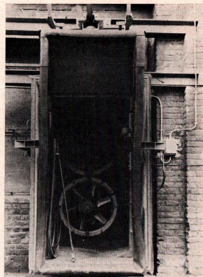
Les ventilateurs hélicoïdaux.
