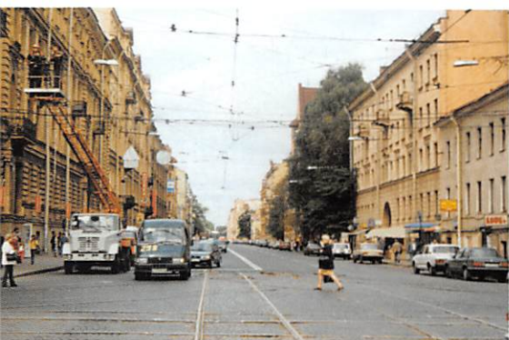
Hier reed enkele weken tevoren de tram nog rechtdoor. De sporen zijn al verdwenen; links doet een bovenleidingsploeg de rest... 8-ya i 9-ya Linea, 22 augustus 2002. (foto Alex Krakowsky)
