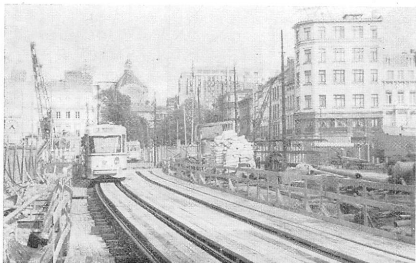
TENIERSPLAATS ; TOESTAND OP 31 JULI 1970 - DE VERPLAATSTE SPOREN OP HET METALEN BRUG- DEK. (Foto's van de schrijver)
