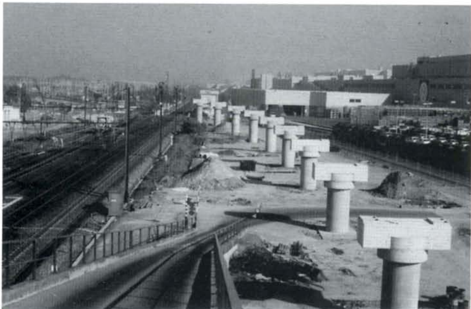
A Forest, les piles du viaduc de la future voie A de la ligne 96A sont construites. La photo est prise de la passerelle de l'usine Volkswagen, qui sera d'ailleurs élargie à deux bandes de circulation. Dans le fond, les quais de la gare de Forest. 13 octobre 1994. Photo : Baudouin DIEU.
