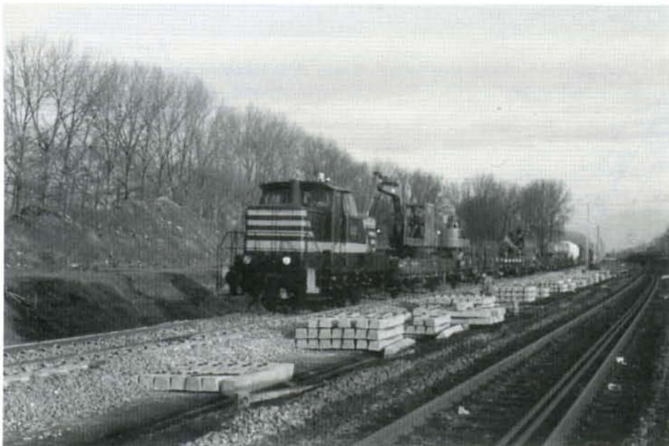
PHOTO 21-41 A Lot, un train de route "caténaires" plante les poteaux sur la future voie B de la ligne 96, à l'endroit où elle contournera le viaduc TGV. On remarque, sous le nouveau ballast, le macadam. L'ancienne voie de la ligne 96A est désélectrifiée et ne tardera pas à être démontée. Lot, 12 décembre 1994. Photo : Jean-Luc VANDERHAEGEN.
