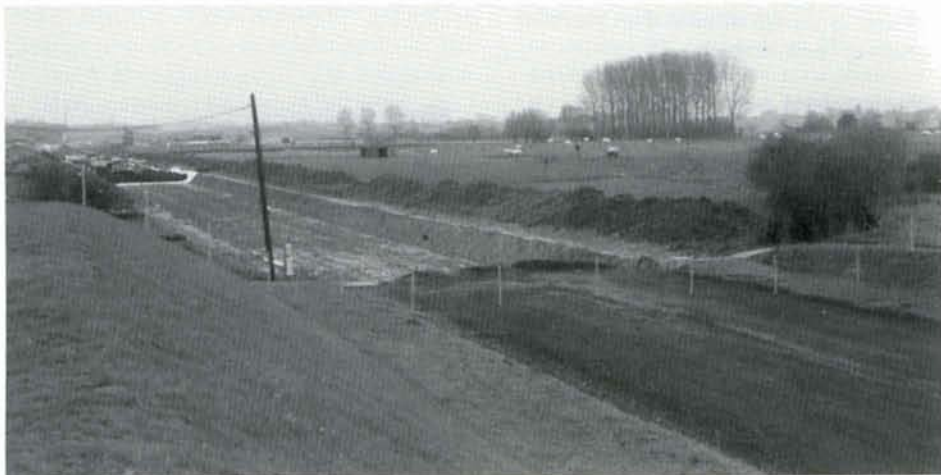
PHOTO 21-39 Frontière Française. Côté France, la plate-forme est achevée. Côté belge, les engins de génie civil arrivent... Remarquez la clôture qui interdit la pénétration sur la ligne LGV-Nord. Esplechin, décembre 1994.
