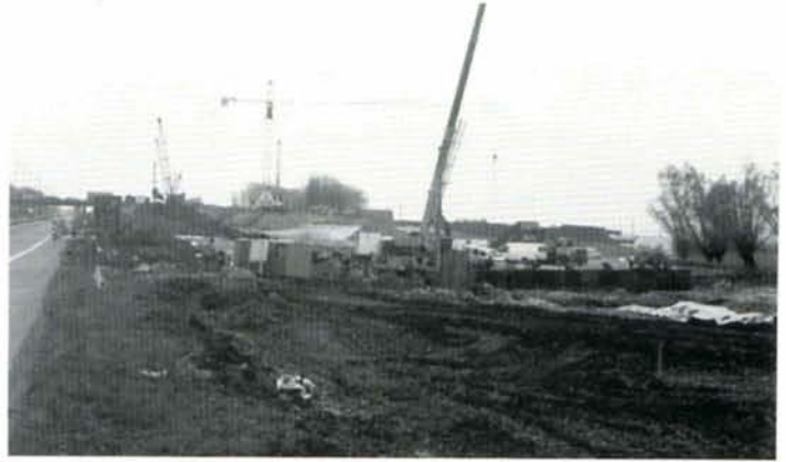
Le long de l'autoroute A8, les terrassements ont commencé. Une vue des chantiers à hauteur de la sortie de Rebecq. Wisbecq, 13 avril 1995. Photo : Baudouin Dieu.
