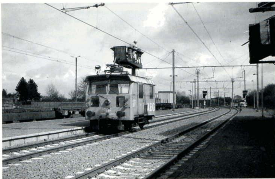
La mise en place de la caténaire sur la ligne 97 St.Ghislain - Quévrain a été assurée par la firme AEG. Elle disposait pour cela de trois véhicules à deux essieux de couleur orange et immatriculée aux chemins de fer Autrichiens. Ici, la mise en place et le réglage des pendules à Quévrain le 29 mars 1995. Photo : Philippe GOUSSET.
