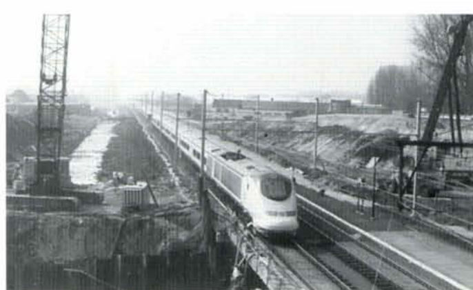
Prise du pont de la gare de Lot au passage d'une rame d'essai Eurostar, cette photo montre l'état actuel du chantier. A gauche, aménagement des futures voies TGV; à droite, remplacement de la voie de la ligne 96A et construction du talus du futur pont; à l'avant-plan, construction de l'ouvrage d'art de franchissement de la Senne. Lot, 11 avril 1995. Photo : Baudouin Dieu.
