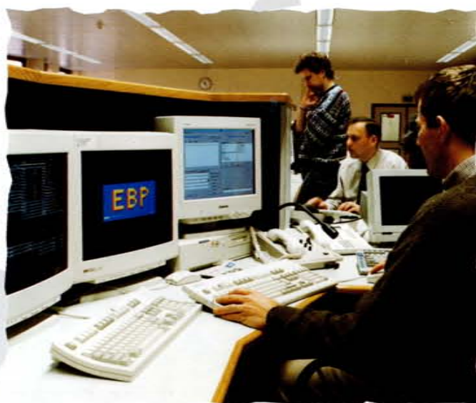
De controle en de opvolging van het treinverkeer verloopt steeds meer geïnformatiseerd in de seinposten.
