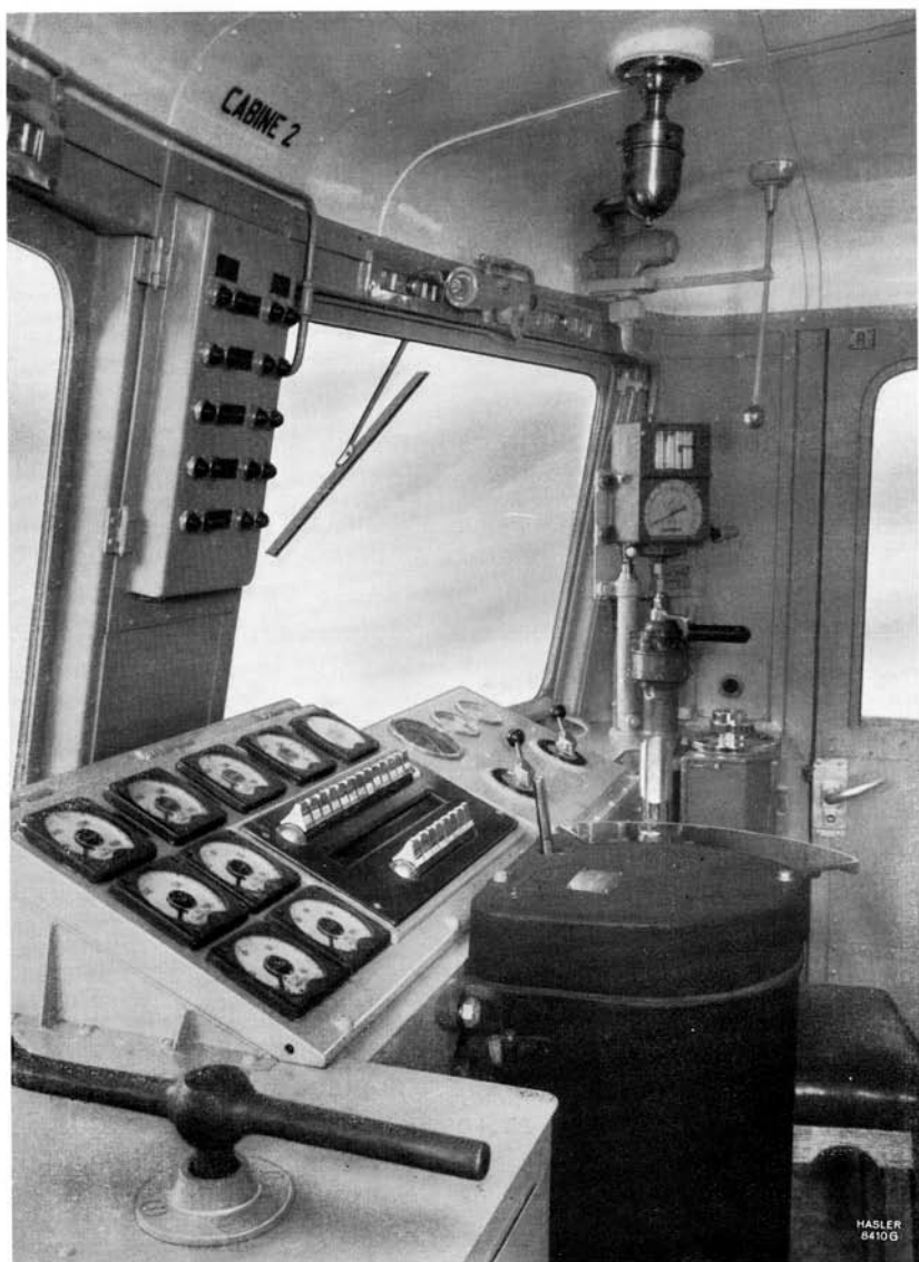
Fig. 4. - Tachygraphe TELOC RT 220 monté dans la cabine d'une locomotive électrique B.B. type 122 de la Compagnie du chemin de fer du Bas-Congo au Katanga (B.C.K.) (Congo belge) (voir fig. 3)
