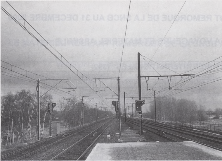
A Epegem, caténares "R3 Cu 100" à gauche et classique 3 kV compound "polygonale" à droite.
