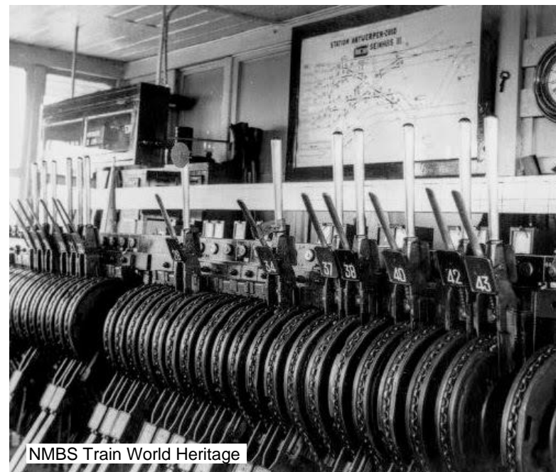
Het interieur van het Siemens-seinhuis III. Bemerkt de typische hendeltrommels en de kettingen die onder het seinhuis verbonden zijn met de trekdraden die op de linker foto te zien zijn.
