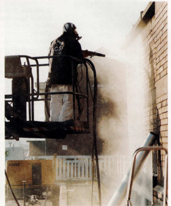
▲ Jurbise: les façades extérieures nettoyées par le procédé de gommage. Cette nouvelle technique, contrairement au sablage classique, n'occasionne aucun dommage à la surface nettoyée.
