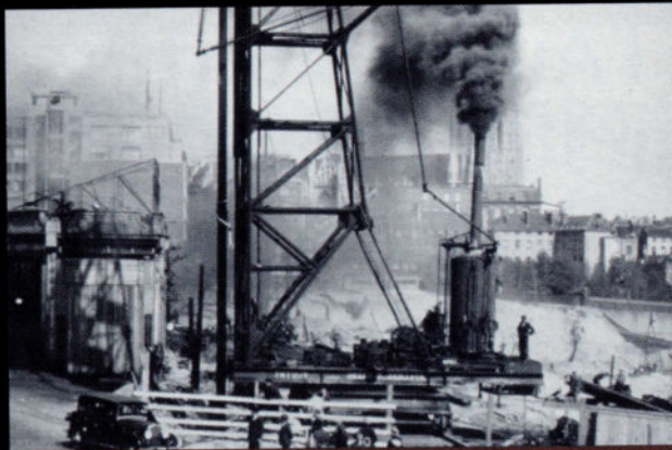
La construction de la jonction Nord-Midi s'avéra laborieuse. Au fur et à mesure que les travaux avançaient, de plus en plus de machines firent leur apparition. Pour enfoncer les pieux, on utilisa un engin à vapeur (1938).
