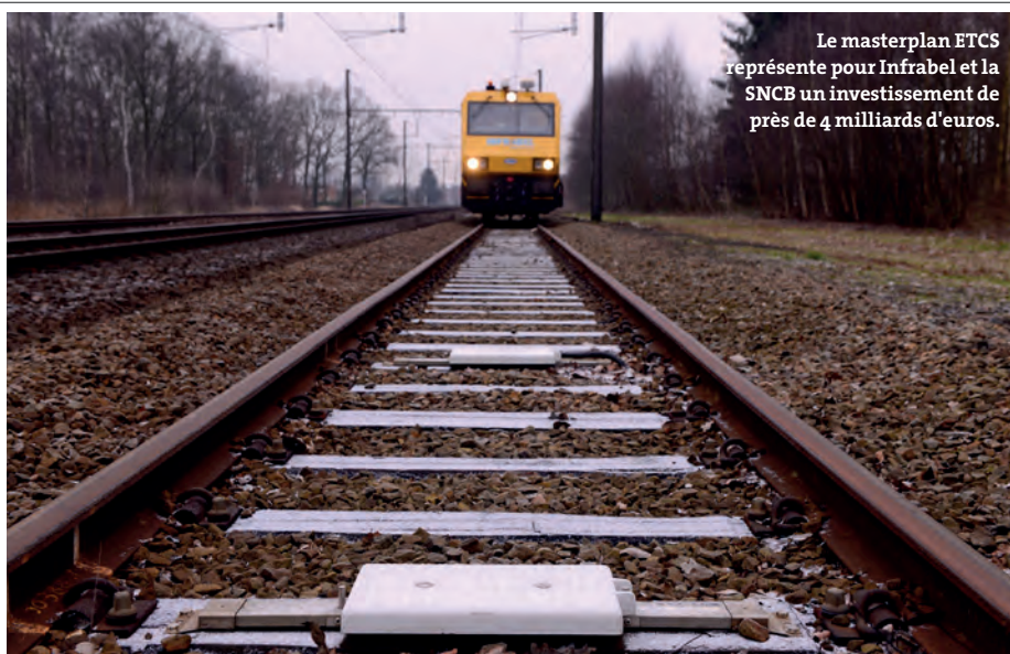
Installation de la TBL1+ sur notre matériel roulant.
