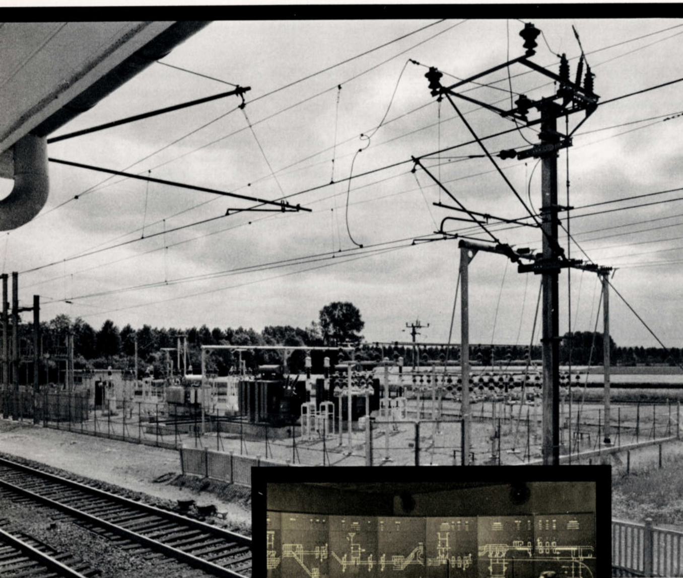
Het onderstation te Longueil-Sainte-Marie.
