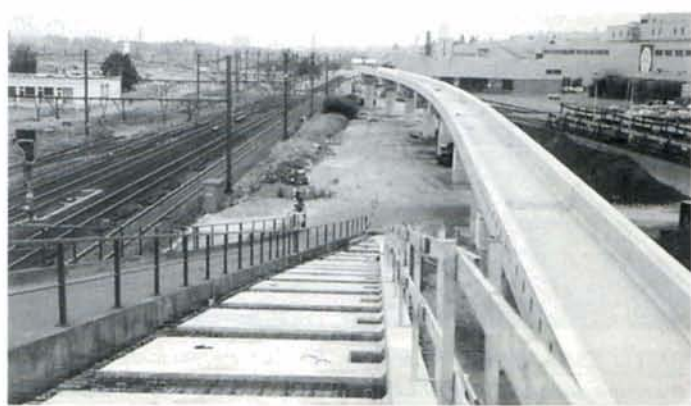
La pose des bacs en béton est terminée sur la première partie du viaduc de Forest-Midi. Ce viaduc permettra à la voie A de la ligne 96A de rejoindre la ligne 96, ainsi que le nouveau faisceau VW.
