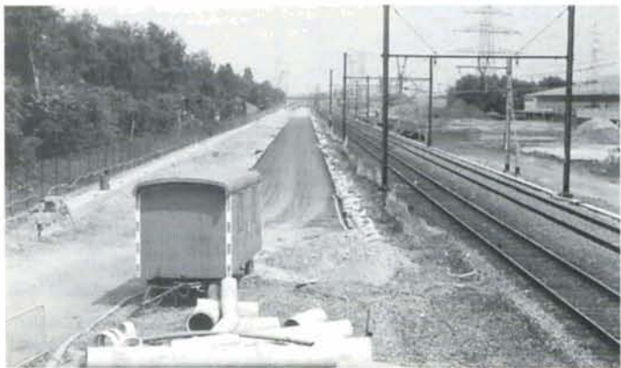
Entre Ruisbroek et Forest, mise en place du tarmac qui recevra le ballast de la voie TGV vers Bruxelles. A droite, l'emplacement du futur faisceau Volkswagen. Ruisbroek, 1-7-95. Ch. DOSOGNE.
