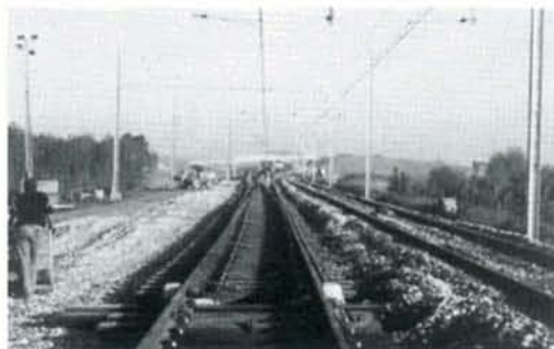
La pose d'un appareil de voie franchissable, en voie déviée, à 160km/h est impressionnante. Pas moins de six vérins hydrauliques mobiles ont été nécessaires pour déplacer sans l'abîmer la pièce assemblée préalablement sur le côté. Une fois mis en place, il reste à le positionner et le relever puis le ballaster. Maubray, pose de l'aiguillage 4, 21 mai 1995. Photo : Vincent HONORE.
