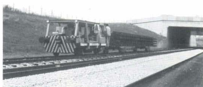
PHOTO 24-15 La "navette", petit engin automoteur, transporte alors les panneaux jusqu'en tête du chantier. Antoing, 25-09-95.
