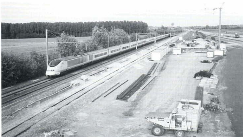
Vue générale de la base du Coucou lors du passage d'un Eurostar vers Bruxelles. A gauche, la ligne 94 et la voie de raccord LGV/ligne 94. Au fond, les voies de service de la future base de maintenance; à droite, la plate-forme des voies TGV. Meslin-l'Évêque, 6 octobre 1995. Photo : Christian DOSOGNE.
