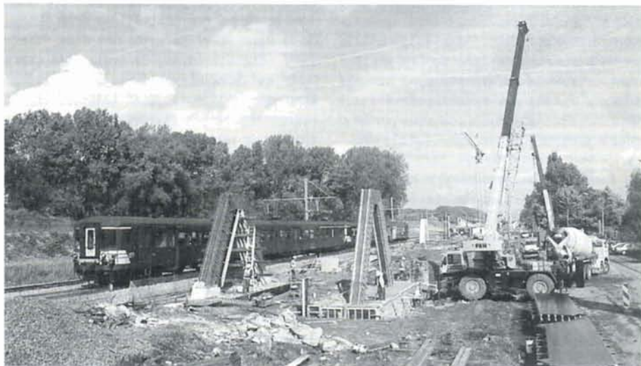
Construction du viaduc de Lot. Un train L Leuven-Braine-le-Comte passe au droit de l'ouvrage, sur la future voie B de la ligne 96. Lot, 3 octobre 1995. Photo : C. DOSOGNE.
