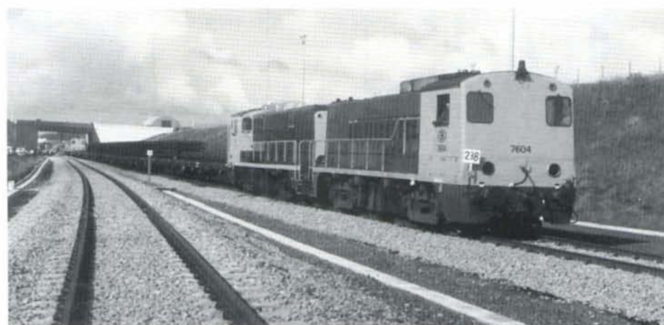
PHOTO 24-14 Les panneaux de voies pré-montés en longueur de 18 mètres, sont acheminés par train sur le chantier. La rame est encadrée par deux unités multiples de locomotives série 76. Sur la ligne nouvelle en construction, les trains sont repérés par un numéro placé dans le porte-disque; ici le 238.
