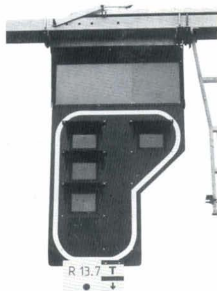
PHOTO 25-49 Un des deux signaux à fibres optiques installé à Hal. Ce signal étant inaccessible, les fibres optiques sont entretenues à partir du sol.
