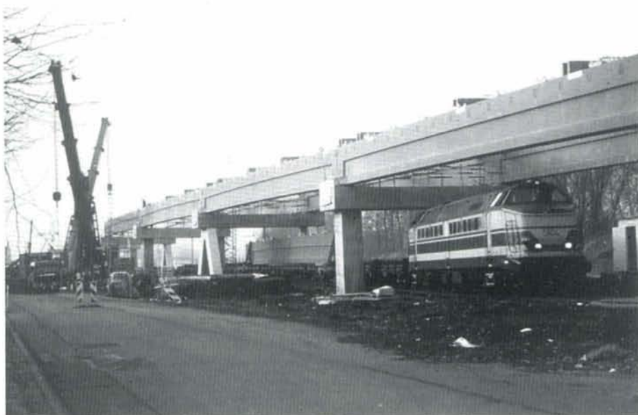
Mise en place de poutrelles acheminées par la 5104 de Schaerbeek depuis les usines Ronveaux de Ciney. L'ancienne voie A de la ligne 96 a été ripée et est utilisée pour permettre le déchargement des wagons. On distingue parfaitement l'avancement du chantier. Lot, 13 décembre 1995. Photo : Christian DOSOGNE.
