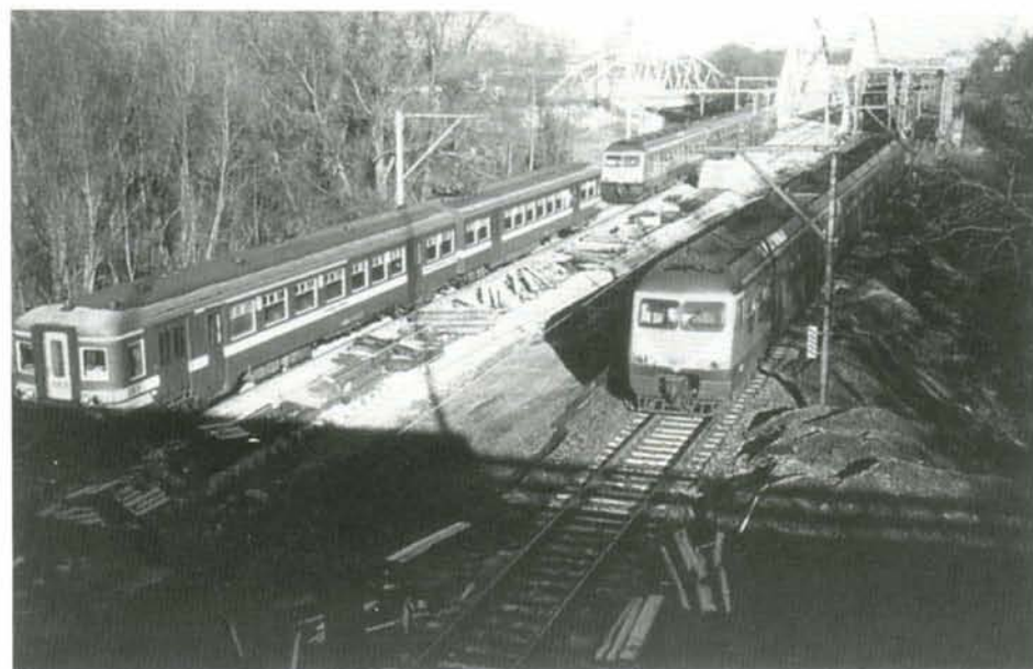
Depuis la fin de l'année 1995, la voie B de la ligne 96 franchit le canal Bruxelles-Charleroi par le nouveau pont métallique. Deux automotrices y sont visibles tandis que circule vers Mons une automotrice triple de la relation Vilvorde-Quévrain. Halle, 29 décembre 1995. Photo : Christian DOSOGNE.
