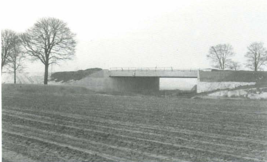
PHOTO 25-57 Entre Antoing et Arbre, plusieurs ouvrages sont en cours de construction, comme ce pont qui enjambe la route Ath-Grandglise. Ormeignies, 16-1-1996. B. DIEU.
