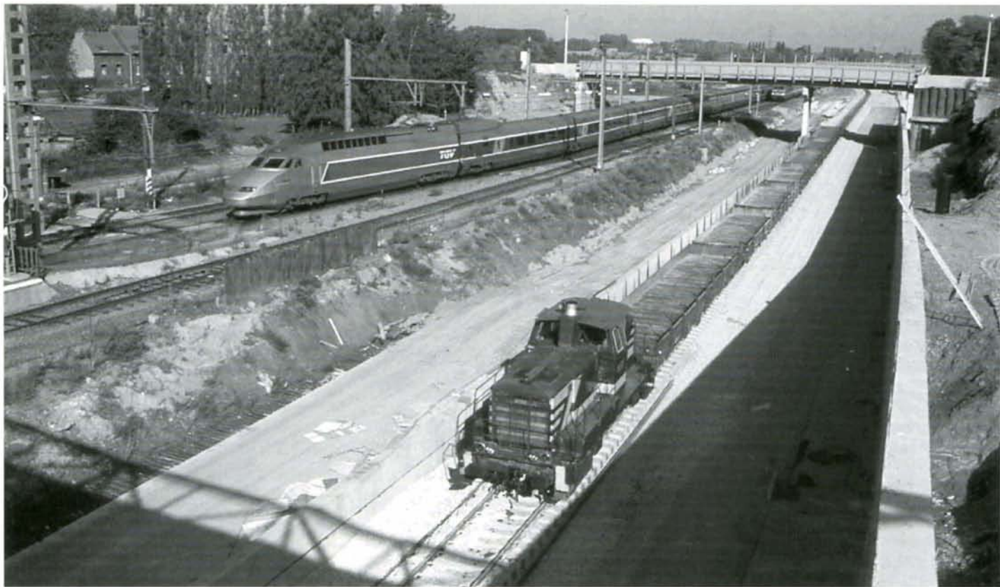
A Halle côté Bruxelles, la future voie 1B TGV est en cours de pose. La 8069 assure un train de travaux alors que passe un TGV de la relation Bruxelles-Paris. Halle, 16 octobre 1996. Dia : Christian DOSOGNE.
