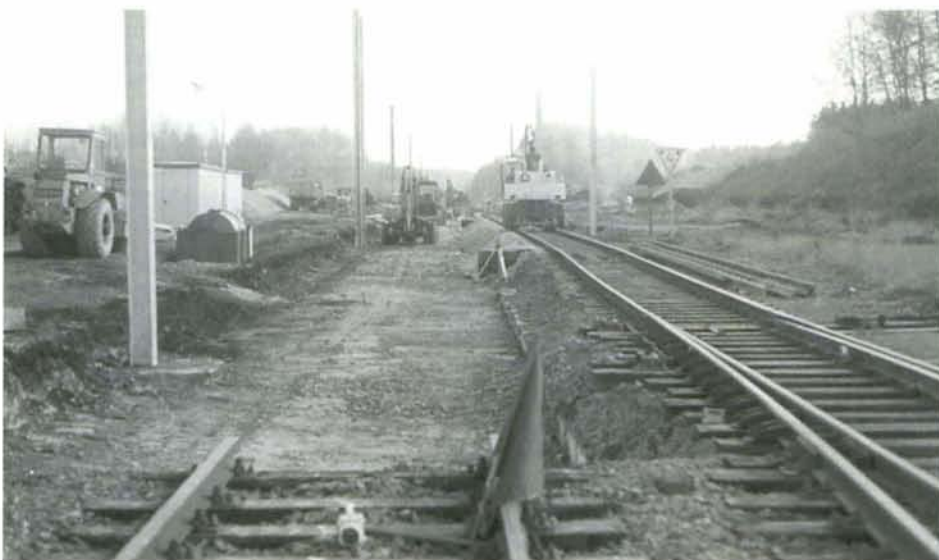
La gare de Paliseul à l'heure des grands travaux de modernisation. 17 novembre 1996. Photo : Marc POTTIEZ.
