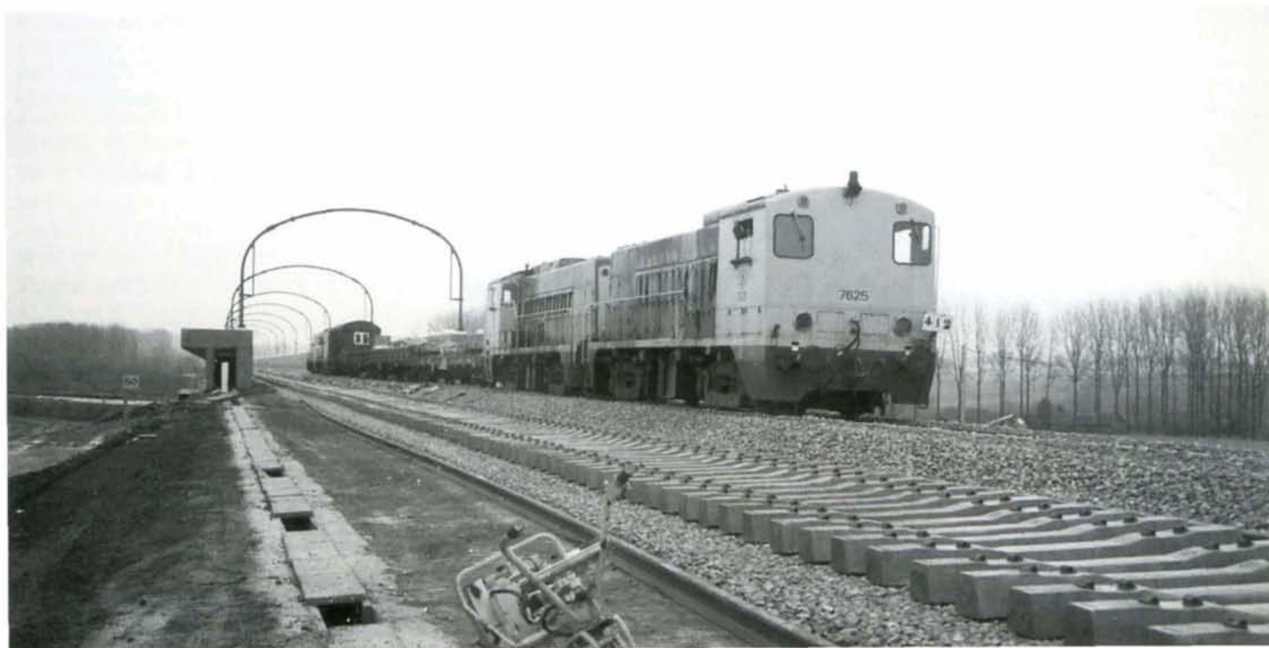
PHOTO 29-34 Le train de substitution dépose les dernières traverses béton qui joignent les tronçons Antoing-Arbre et Arbre-Rebecq, à l'endroit précis où se rencontreront demain les autorités politiques et ferroviaires. Arbre, 26 novembre 1996. Photo : Philippe SCHOLL.
