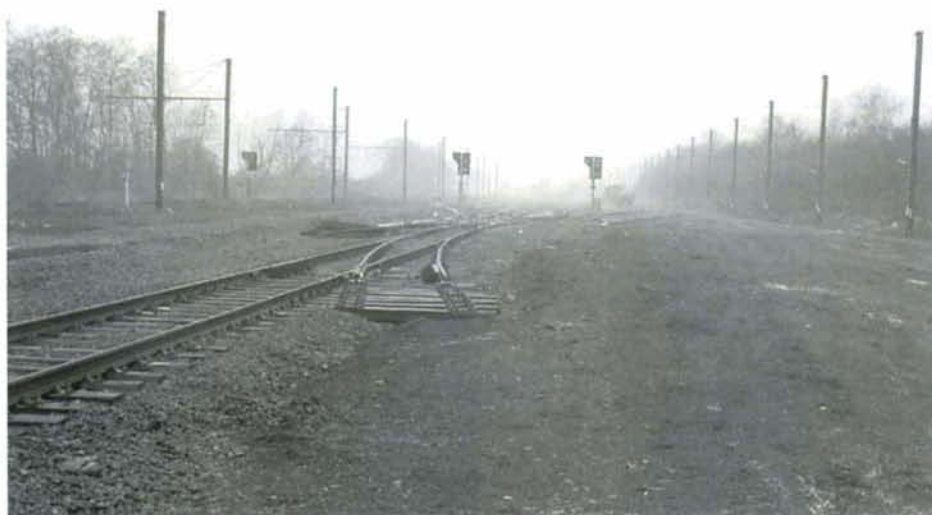
PHOTO 29-35 Le faisceau de réception de la gare de Voroux est maintenant renouvelé. Il servira à la réception des trains d'approvisionnement de la ligne nouvelle. Voroux, 28 janvier 1997. Photo : B. DIEU.
