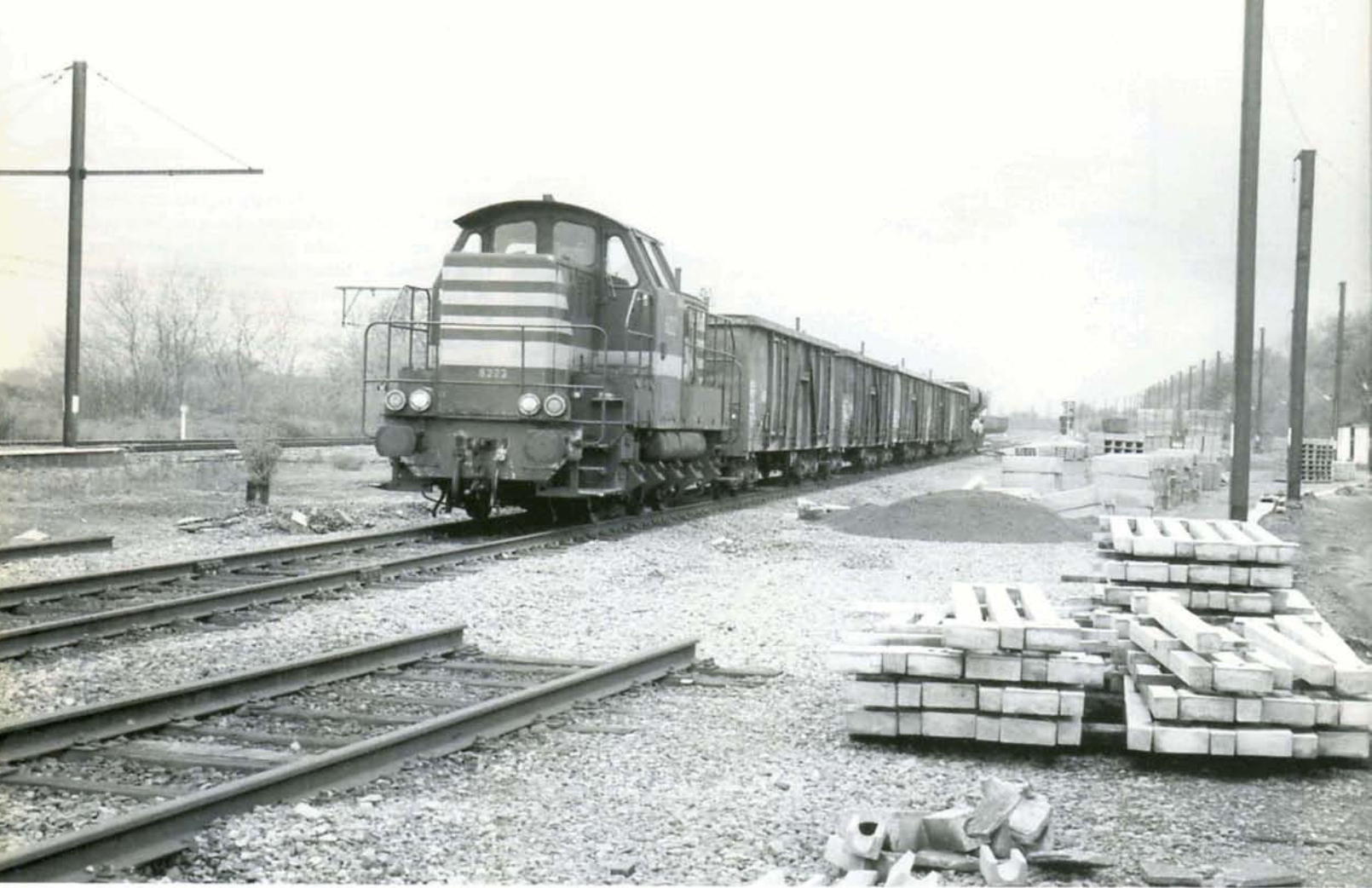
PHOTO 30-45 La locomotive 8222 de Kinkempois manoeuvre un train de travaux dans l'ancienne gare de formation de Voroux. Le faisceau de réception, où opère le train, était électrifié et permettait essentiellement l'échange de locomotives. Il sera utilisé, dans le cadre de la base de travaux, comme faisceau de réception pour les trains venant ou partant vers Kinkempois. Voroux, 29 avril 1997.
