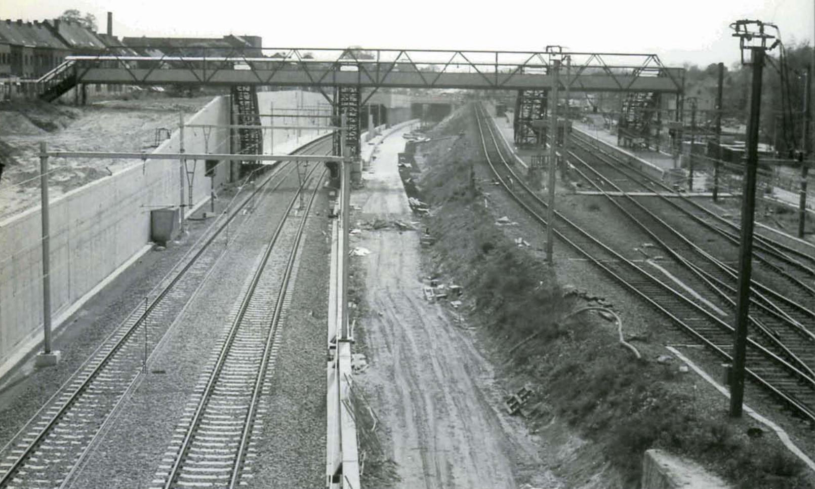
PHOTO 30-40 A Halle, le pertuis des voies TGV est en cours d'achèvement. La voie est posée et la caténaire tirée. Des quais provisoires permettront d'utiliser les voies TGV comme voies de réception voyageurs le temps de parachever les autres pertuis. Halle, 23 avril 1997. Photo : B. DIEU.
