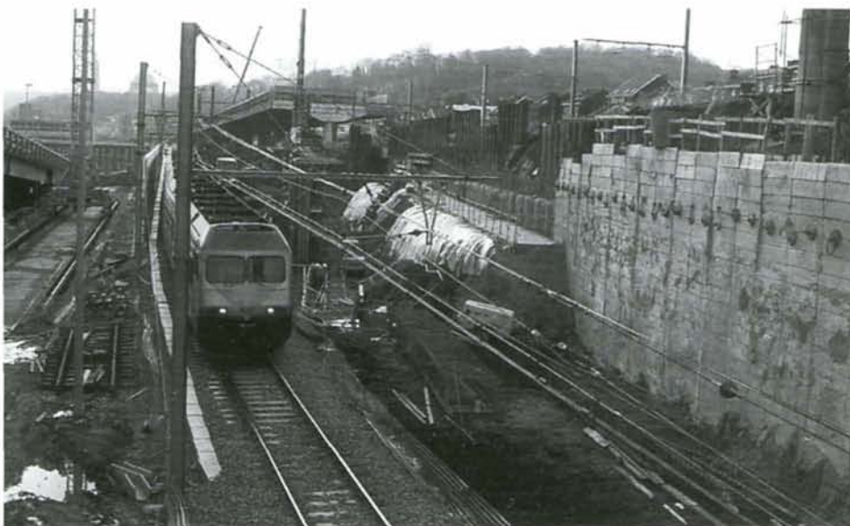
PHOTO 37-59 Les travaux à l'entrée de Liège Guillemins. Venant de Liège-Palais, une voie unique provisoire est instaurée, tandis que se construit le passage inférieur sous lequel passera la ligne 34. Liège, 21 janvier 1999. Photo : Baudouin DIEU.
