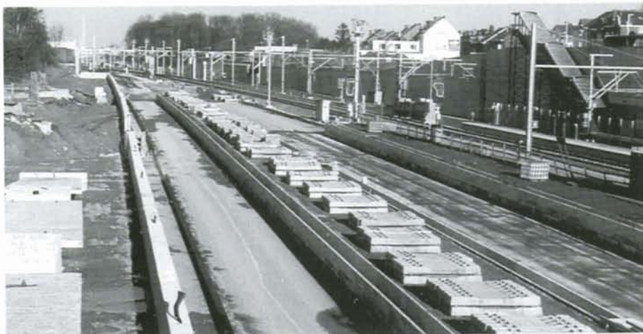
PHOTO 37-53 La gare de Halle côté Bruxelles. La voie 1 va être posée et servira dès le mois de mai à la réception des trains de la ligne 26. Au centre, la plateforme de la future ligne 94. Halle, 30 janvier 1999. Photo : Baudouin DIEU.
