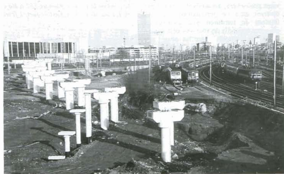
PHOTO 37-55 A l'entrée de Bruxelles-Midi, les deux voies TGV enjambreront littéralement l'entrée de la gare pour accéder directement au terminal TGV. Le viaduc est en construction. Bruxelles-Midi, 30 décembre 1998. Dia : Christian DOSOGNE.
