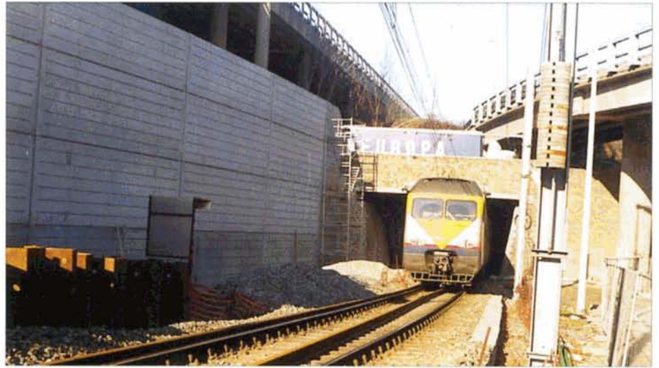
PHOTO 41-70 Site de Hemricourt. Venant des Guillemins, l'automotrice 319 vient d'emprunter une trémie d'accès provisoire qui lui permet de s'engouffrer dans le tunnel des Palais. La double voie devrait être rétablie dans quelques mois. Liège, 25 janvier 2000. Baudouin DIEU.
