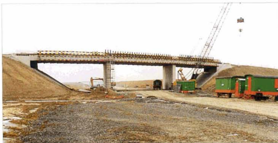
PHOTO 41-68 La ligne nouvelle entre Crisnée et Bierset. Dans cinq mois, la voie devrait recouvrir la plateforme. La sous-couche n'est pas encore mise en oeuvre... Voroux, 27 janvier 2000. Baudouin DIEU.
