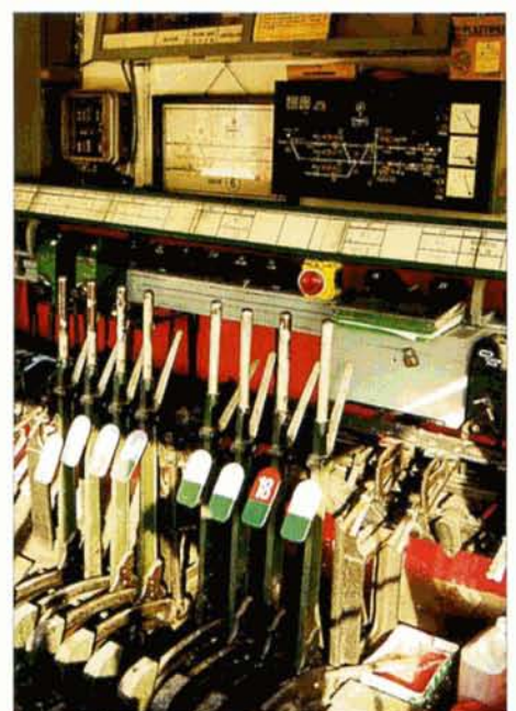
PHOTO 41-54 Vue intérieure du bâti Saxby du block 6 de Binche. Tout un passé qui bientôt aura disparu.
