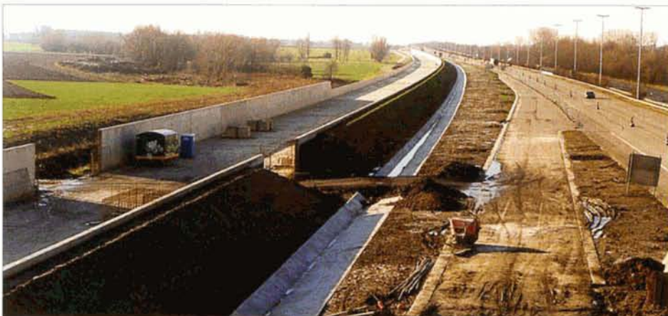
PHOTO 41-66 Le tracé de la ligne nouvelle à hauteur de la station-service de Bettincourt vers Leuven. Les mauvais terrains ont exigé la constitution d'une plateforme bétonnée. Bettincourt, 24 janvier 2000. Baudouin DIEU.
