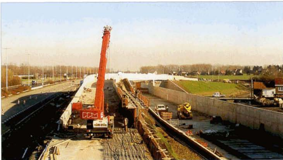
PHOTO 41-67 La sortie vers la station-service nécessitera un passage supérieur. Bettincourt, 24 janvier 2000. Baudouin DIEU.
