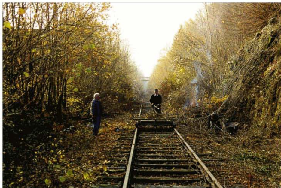
Travaux de débroussaillage de la ligne 128. La gare de Dorinne-Durnal est désormais à portée de vue! Alain DEFECHEUX, 13 novembre 1999.
