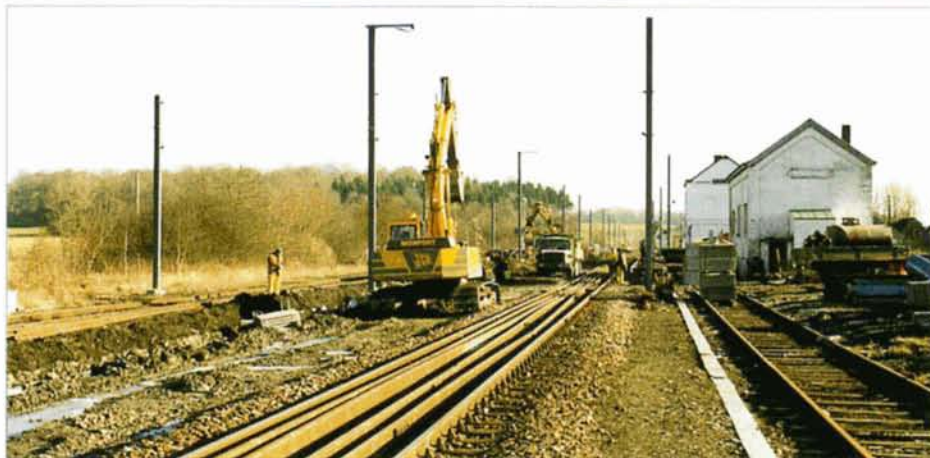
PHOTO 42-66 Depuis le début de l'année, la gare de Florenville est le théâtre d'importants travaux de voies dans le cadre de l'électrification de l'Athus-Meuse. Ce document témoigne de l'ampleur des travaux. Dave HABRAKEN, 24 janvier 2000.
