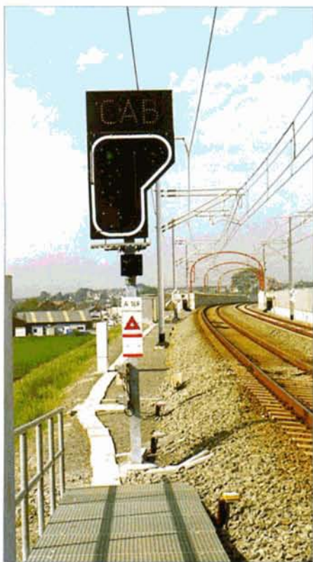
PHOTO 43-12 Un signal «CAB» autorisant l'accès vers la ligne LGV, ici à la sortie du viaduc de Lembeek. L'indication CAB allumée signifie qu'en aval de ce signal, c'est la signalisation de cabine qui doit être observée. Ce signal est équipé d'un «commutateur de protection» (le petit triangle rouge sur fond blanc) dont la manoeuvre permet au conducteur obligé d'intervenir dans les voies d'assurer sa protection vis-à-vis des autres mouvements. Philippe SCHOLL.
