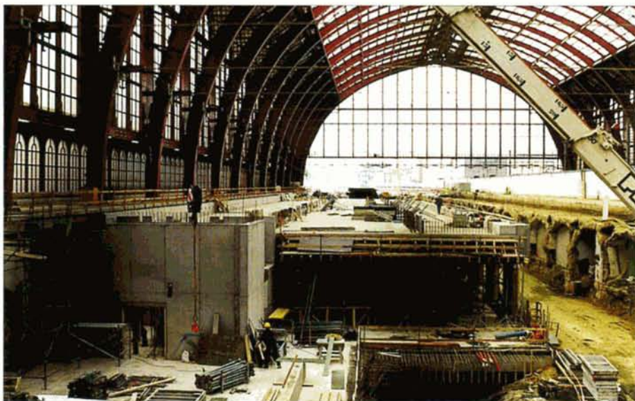
PHOTO 43-85 La construction de "cathédrale" d'Antwerpen, à hauteur des futures voies 4 à 6. On distingue nettement les deux niveaux supérieurs. Marc GRIETEN, 23 mai 2000.
