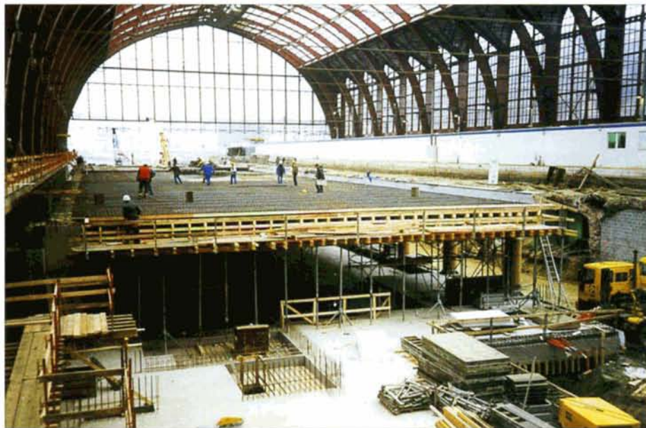
La couverture des niveaux inférieurs se poursuit sous la coupole d'Antwerpen-Centraal. La fin des travaux reste programmée pour 2005. Armand THONET, 31 août 2000.
