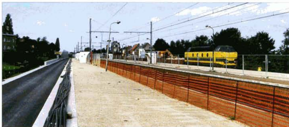
PHOTO 44-69 Gare de Diegem. L'assise de la voie B vers Bruxelles est prête; la voie A est posée et en cours d'électrification. La 6268 opère en tête du train de travaux CEI. Diegem, 2 octobre 2000.
