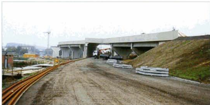
PHOTO 44-73 A l'entrée de Leuven côté Bruxelles, les deux voies TGV passeront au-dessus de l'ouvrage, tandis que la voie B de la ligne 36 (vers Bruxelles) sera en-dessous. A gauche, l'amorce vers le viaduc du canal Mechelen-Leuven. Leuven, 02-10-2000. B. DIEU.
