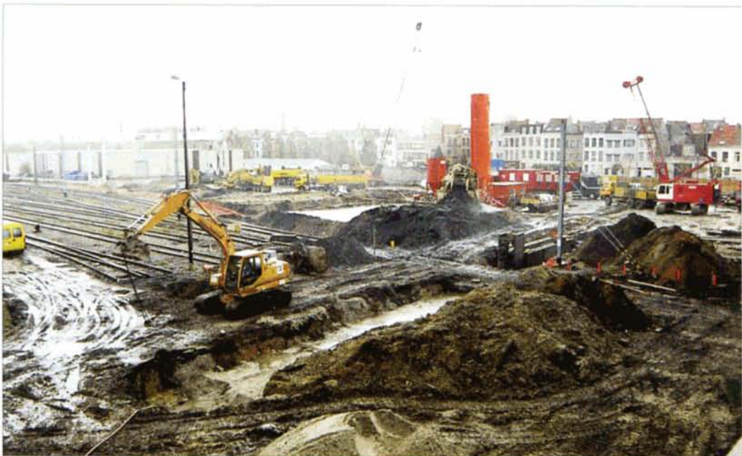
PHOTO 48-87 C'est dans les voies de l'ancien atelier de traction, visibles à gauche, qu'on débuté les travaux de préparation du creusement de la Jonction Nord-Sud; les premiers pieux emboués ont été foncé en ce jour de pluie diluvienne. Antwerpen, 9 novembre 2001. B. DIEU.
