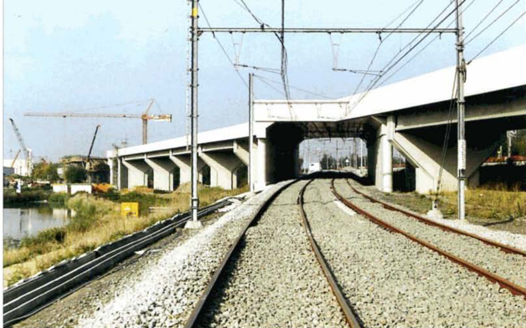
PHOTO 48-80 Passant sous les nouveaux ouvrages d'art côté Bruxelles, les nouvelles voies d'accès à la gare latérale et aux voies 1 et 2 sont posées et électrifiées. Il ne manque que les trains en ce jour de grève... Baudouin DIEU, 17 octobre 2001.
