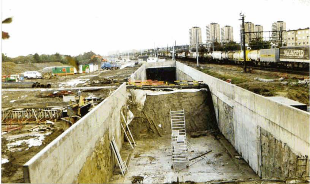
PHOTO 48-86 La sortie du tunnel de la L4 côté Hollande. Il est terminé mais s'achève dans le talus de la Havanastraat, près du point d'arrêt de Noorderdokken. Antwerpen, 9 novembre 2001. Baudouin DIEU.
