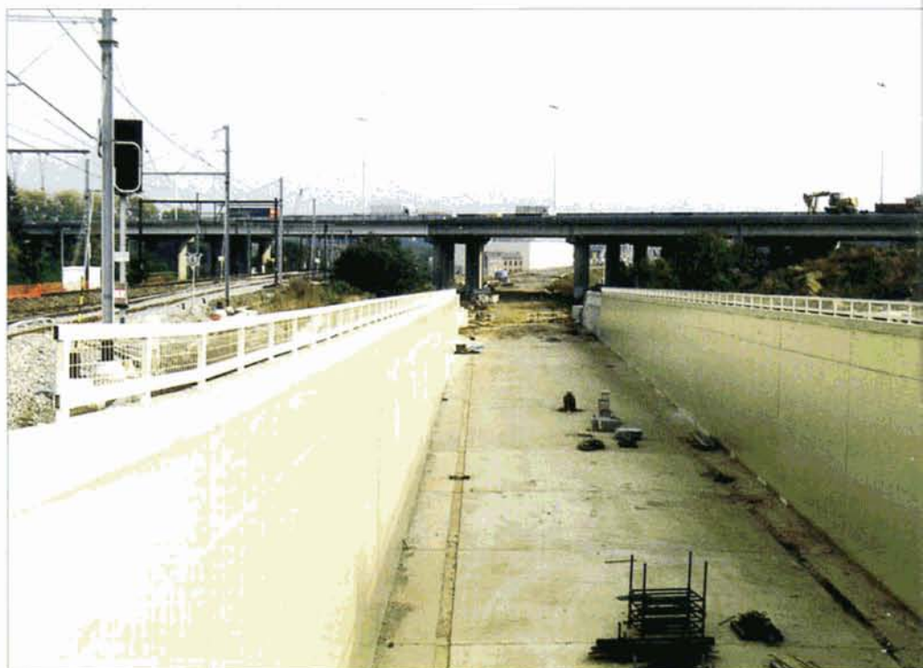
PHOTO 48-78 La trémie d'accès et le tunnel permettant aux deux voies TGV d'accéder en gare de Leuven par le nouveau tracé sont prêts. A gauche, la nouvelle voie B de la ligne 36 est en service. Baudouin DIEU, 17 octobre 2001.
