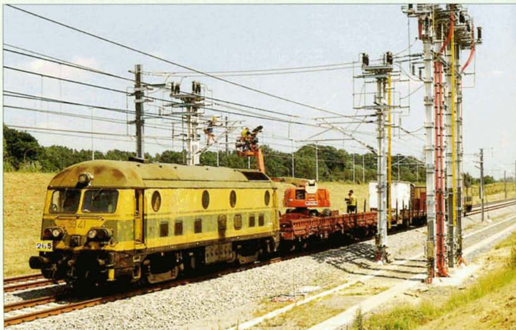
PHOTO 54-33 Le 26 juin 2002, la 5941, bien qu'appartenant alors au PFT, assurait un train d'électrification au sas d'alimentation en 25 kV de la LGV2 à Avenas. La 5916 est accouplée à l'autre extrémité. Serge MARTIN.
