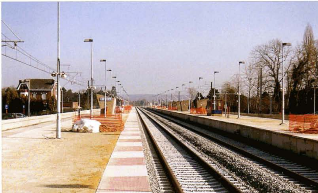
Le nouveau point d'arrêt de Herent. Au centre, les voies de la nouvelle ligne 36N, posées mais non électrifiées. Elles permettront un passage des trains à 160 km/h. A l'extérieur, les voies, en service, de la ligne 36. La passerelle pour piétons a disparu, au profit d'un large passage sous voies. Herent, 13 février 2003. Baudouin DIEU.
