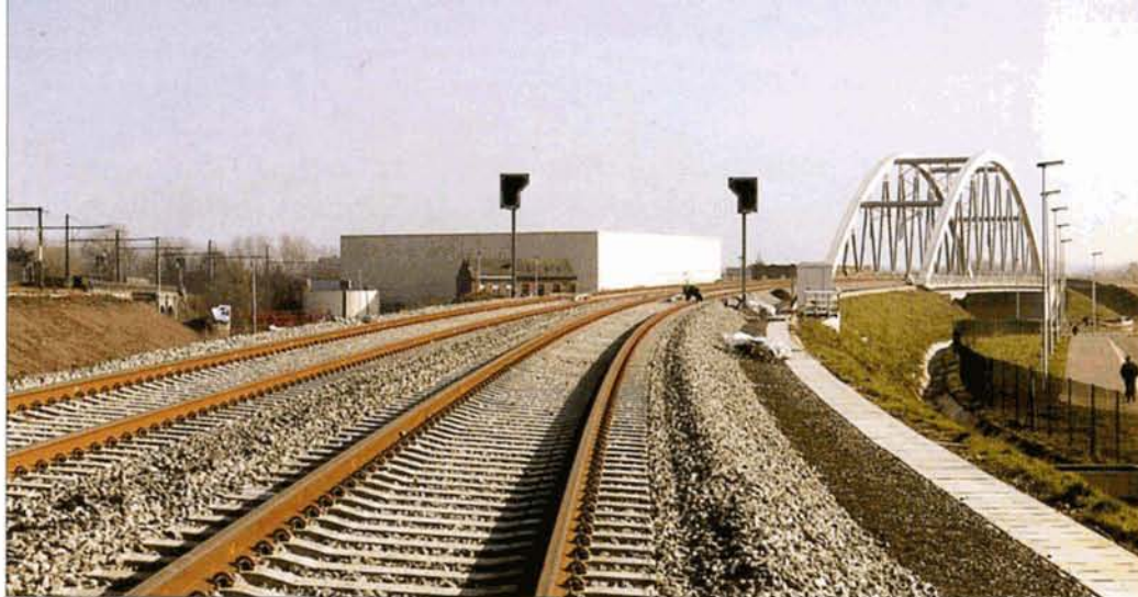
La ligne 36N entre Herent et Leuven. Ici aussi, les voies sont posées. Dans le fond, le viaduc métallique sur le canal de Leuven à Mechelen. La signalisation lumineuse est en place. Baudouin DIEU, 13 février 2003.
