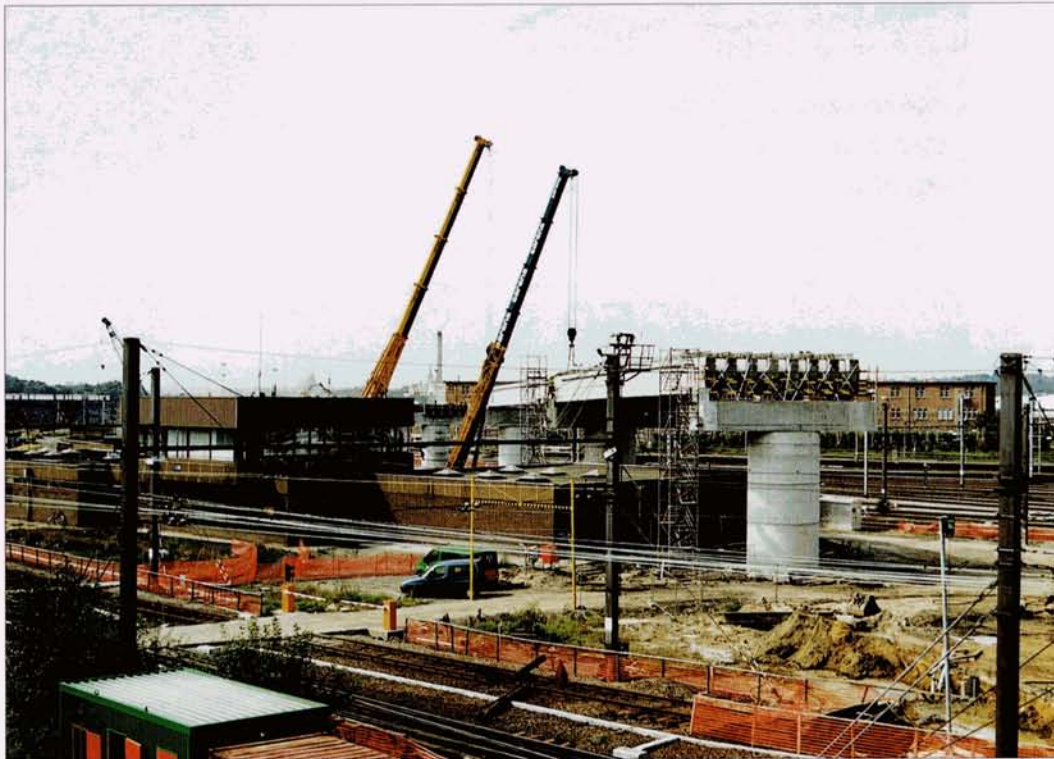
Les premières poutrelles en béton du viaduc qui surplombera les voies des faisceaux de garage de Schaerbeek sont posées. A gauche, le block 8 qui commande, entre autres, le groupe R. Schaerbeek, 5 septembre 2004. Baudouin DIEU.
