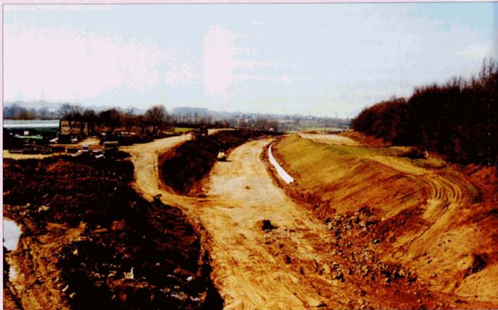
Les travaux de terrassement à Eupen. La tranchée est creusée, mais il reste encore à construire les ouvrages d'art sur la route Eupen - Welkenraedt. 20 mars 2005.
