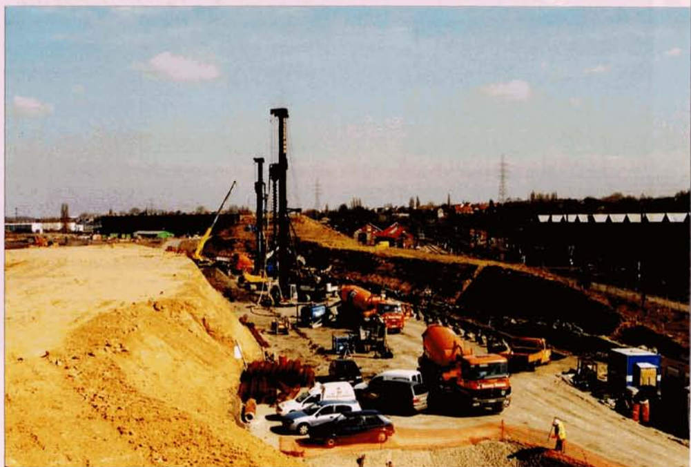
C'est ici, à hauteur de l'atelier de traction, visible à droite, que la voie B de la ligne nouvelle venant de Mechelen passera sous les deux voies de Liège. L'ouvrage d'art est en cours de construction. Schaerbeek, 24 mars 2005. Baudouin DIEU.
