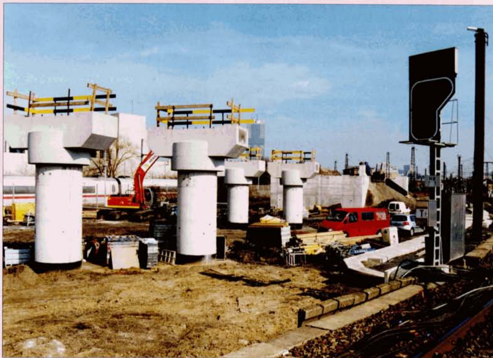
La culée du viaduc TGV à l'entrée de Bruxelles-Midi est terminée et les piles coulées. Il reste à poser les ponts-bacs. Bruxelles-Midi, 15 mars 2005. Baudouin DIEU.
