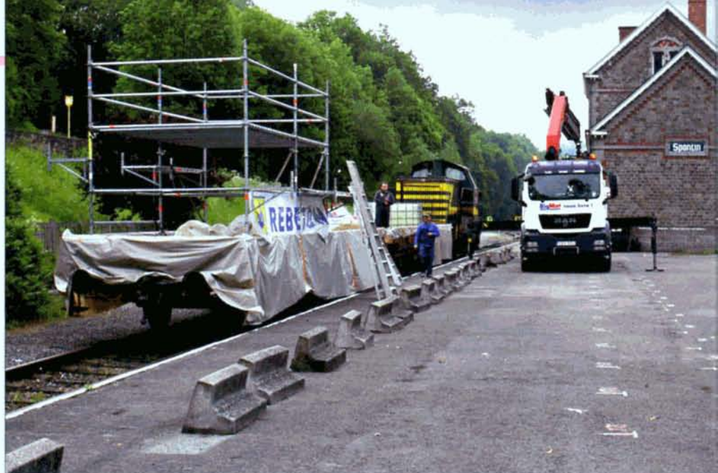
↑↓ Ces deux photos montrent le train de travaux opérationnel pour le gunitage du tunnel de Spontin. C'est la 7305 qui assura la traction du convoi. PFT.
