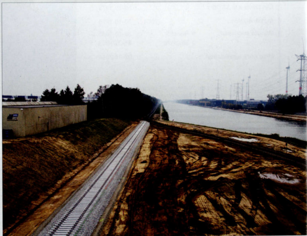
Pour permettre l'élargissement du canal Albert et l'augmentation du gabarit des bateaux l'empruntant, la ligne industrielle 207 va être déplacée dans les environs de Punt (Olen). Andy ENGELÉN, 13 octobre 2015.
