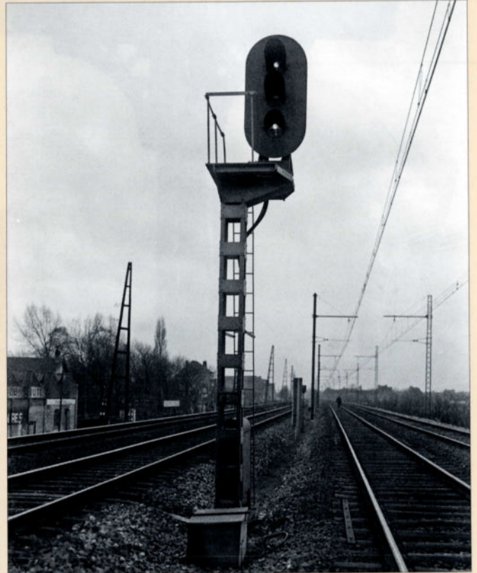
Signal avertisseur à trois feux implanté à l'entrée de la gare de Vilvoorde en venant d'Antwerpen Photo SNCB.
