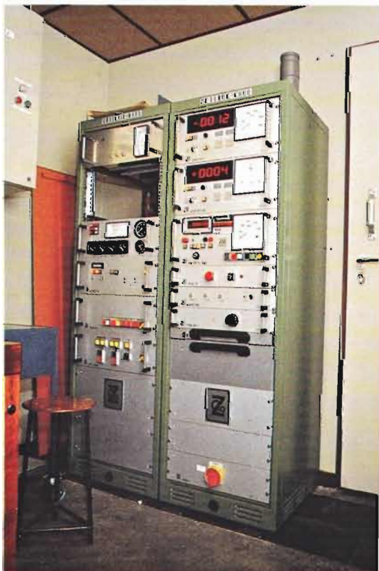
Elektronische sturingsapparatuur — MIVA-garage — 25.4.1988.
