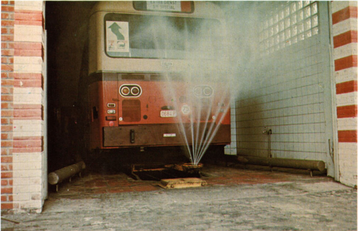
Wasinstallaties voor autobuschassis.
