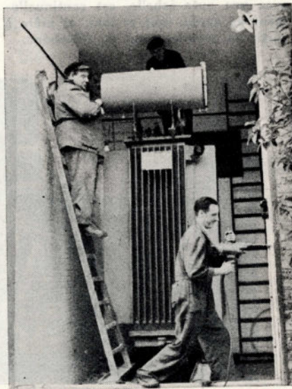
Montage de la cellule d'un transformateur à la sous-station de Laeken. Nous voyons, monté sur l'échelle, Rasschaert, chef monteur — sur le tranfo, Van Buggenhout — à droite, Koklenberg.
