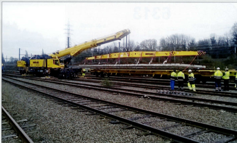
De Multi Tasker 1200-kraan van Infrabel in actie te Schaarbeek bij het vervangen van een wissel. Met deze nieuwe kraan wordt het werk veel sneller en nauwkeuriger uitgevoerd. Infrabel, 28 januari 2016.
