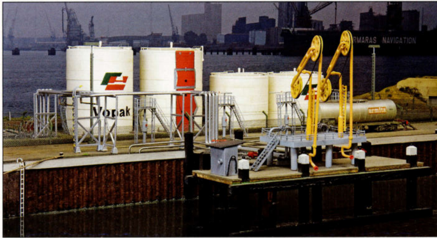
'Kaj-M' avec le team Montfrooij pouvait à nouveau être admiré et détaillé plus avant. A proximité du terminal pétrolier se trouve maintenant une véritable installation de remplissage pour les wagons-citernes, comme il en existe une sur la jetée, pour les navires. L'arrière-plan est désormais achevé en mat, afin que les lampes ne s'y reflètent plus.
