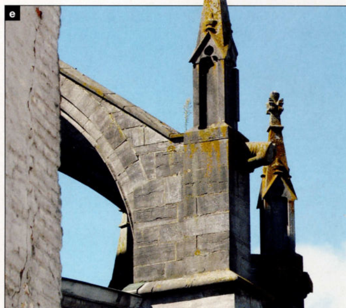
Photo e: Des lichens plus structurés colonisent parfois des surfaces entières, comme ici les pinacles de l'église de Walcourt. Ceux-ci sont très courants, aussi sur d'autres types de pierre, ou sur le béton.
