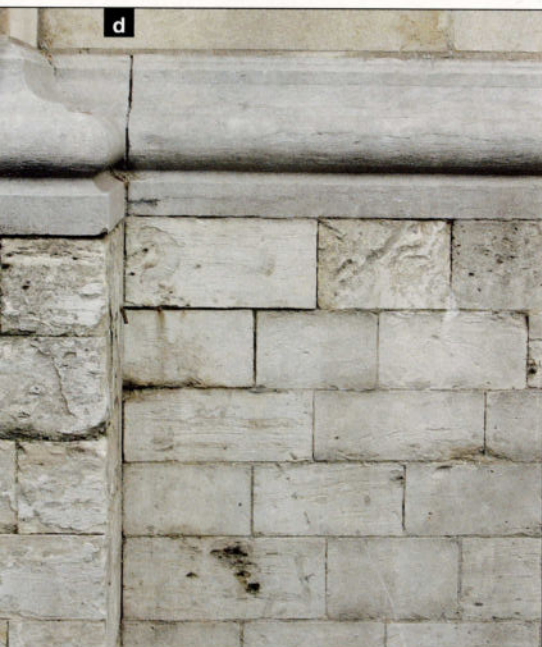
d Le soubassement de la cathédrale de Malines est constitué de pierres de Gobertange. Nous reconnaissons cette importante variante de pierre aux formes de vagues qu'elle présente en surface.
