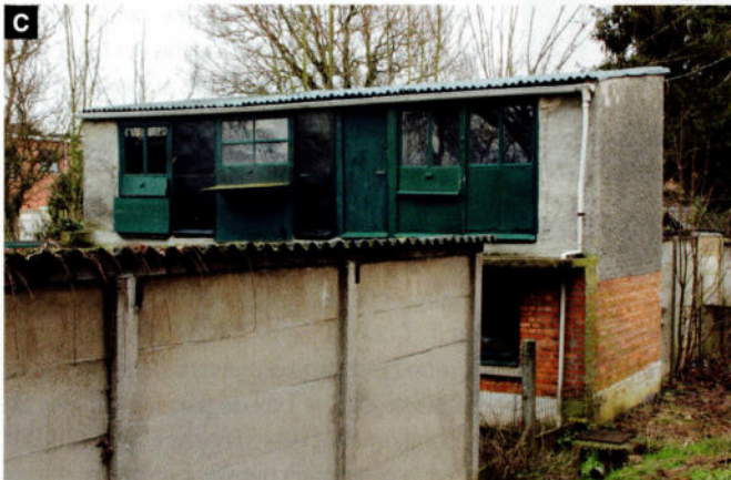
C. La corniche avec son écoulement, fixé par un unique étrier rouillé.
