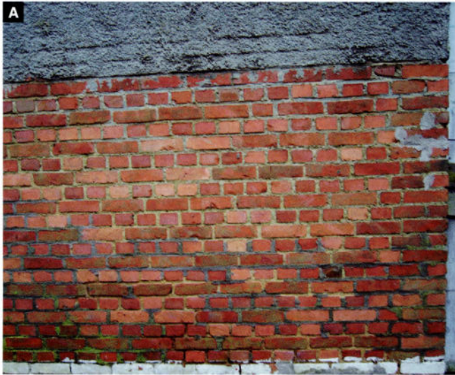
A. Détail de l'enduisage et de la maçonnerie: observez les différentes teintes des joints.
