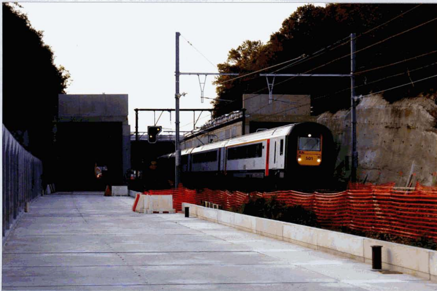
PHOTO 94-94 A hauteur de la rue des Renivaux, située entre Ottignies et la bifurcation de Louvain-la-Neuve-Université, les quatre voies seront couvertes par un tunnel, ce qui permettra de supprimer le passage à niveau. Sur cette vue prise en direction de Bruxelles, on peut voir les travaux de couverture des voies, constituée d'éléments en béton préfabriqués, lesquels sont mis en place durant la nuit. Passage d'un IC-J Bruxelles-Midi - Luxembourg. Ottignies, 19 septembre 2009. Olivier JOASIN.
