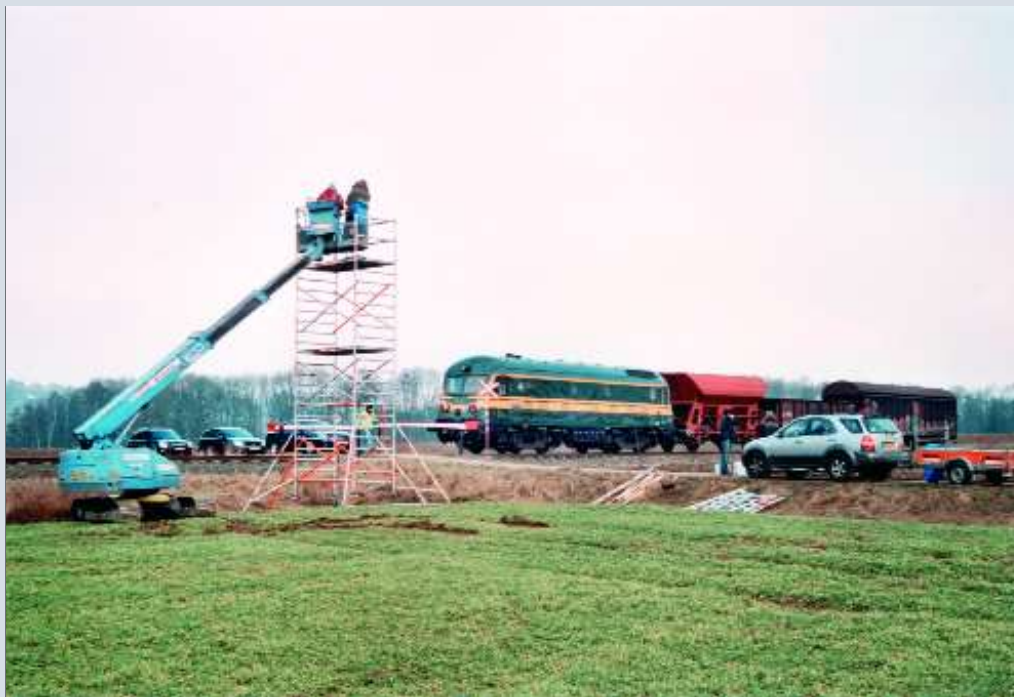
Na de 202.020 in 2004 stond deze keer de 5941 in het voetlicht als vedette in een reclamespot. De opnamen werden gemaakt aan de overweg van Gemenne op L128. Foto TSP.
