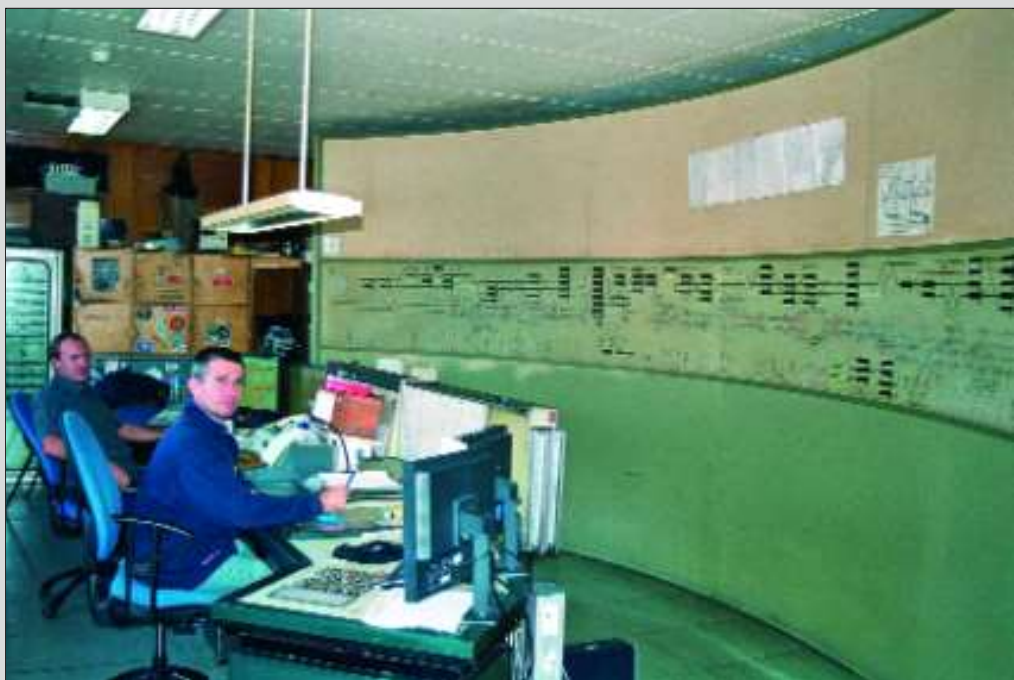
Het speciale aan de dispatching van Mons is het feit dat zij vanop afstand heel lijn 96 bedient van Halle tot Mons en het verkeer regelt van Brussel-Zuid tot Quévy. Zij zijn de enige die nu nog actief zijn, in afwachting van de indienstname van de EBP-post te Mons.
