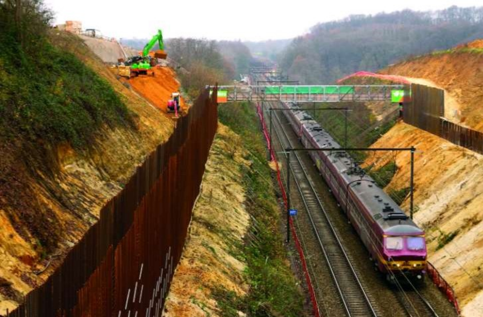
FOTO 89-22 Tussen Profondsart en Ottignies wordt de bedding voorbereid om aan beide kanten van de bestaande spoorlijn een nieuw spoor aan te leggen. Hier zien we de bouw van een overdekte sleuf van 600m lang, vanop de brug van de rue Léon Lekaise. Deze brug zal worden afgebroken, en het autoverkeer zal over het dak van de overdekte sleuf de overkant van de spoorlijn bereiken. Motorstel 802 rijdt hier een IR-trein naar Louvain-la-Neuve Université en zal binnen enkele ogenblikken in Ottignies stoppen. Limelette, 27 november 2008. Geert PACKET.
