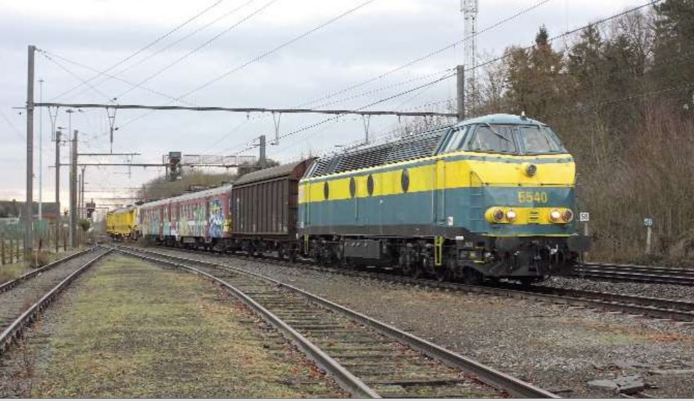
↑ FOTO 102-XX Aankomst van de 5540 in het station van Brugelette met de wagen Hbis, de 219, een kraan van 10t en de hersporingstrein van Kinkempois. P. HERBIET.
