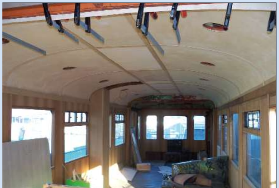
De restauratie van de Brossel-motorwagen 551.26 werd in september 2011, bij het begin van het nieuwe schooljaar, hervat. De afwerking van het interieur is bijna klaar. Deze foto werd op 15 november 2011 gemaakt. Freddy DELARBRE/TSP.
