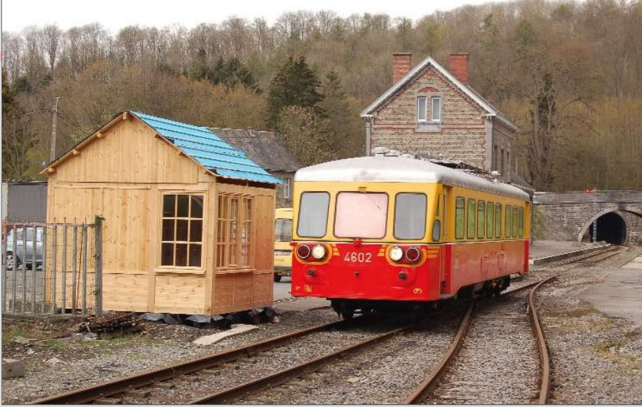
De bouw van Blok 3 te Spontin is bijna beëindigd. De binneninrichting wordt binnenkort aangebracht. Spontin, 23 april 2012. Foto's CFB / Benoît VAN ASTEN.
